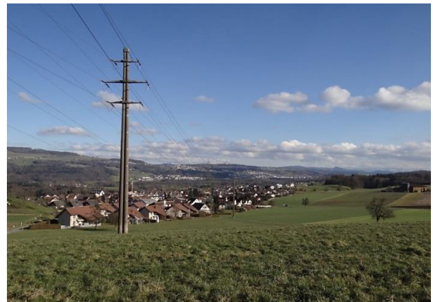
50-kV-Leitung in der Gemeinde Niederwil
