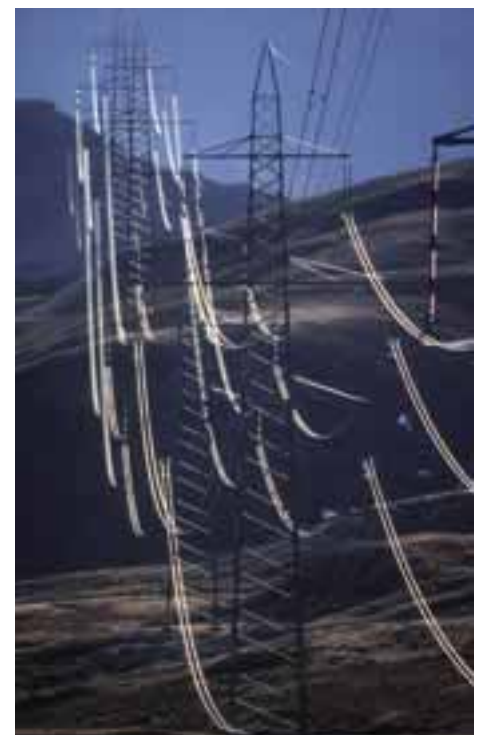
220-kV-Freileitung bei Laax GR.
